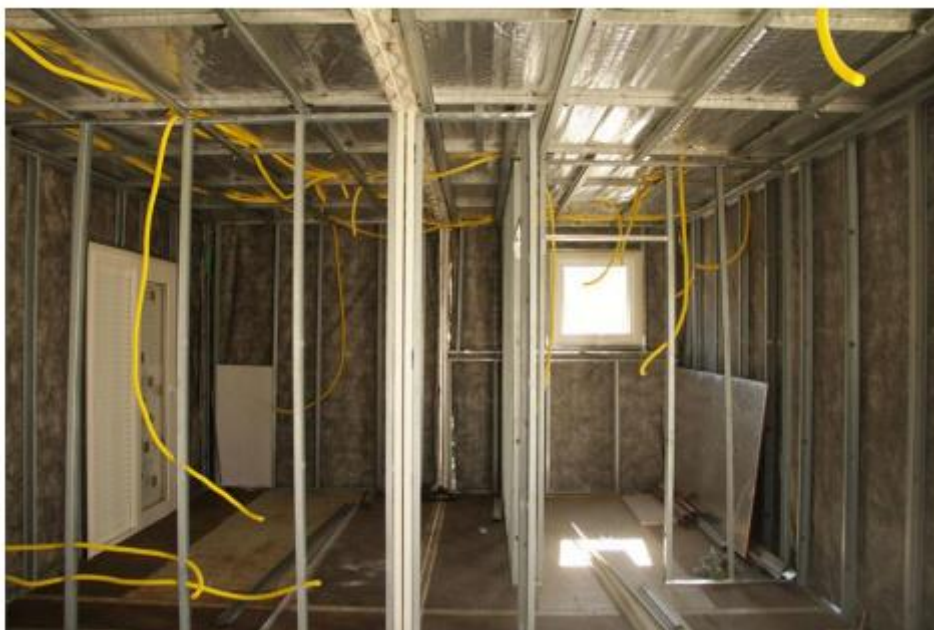
Figura 14 - Instalações elétricas e hidros sanitária de uma construção em Container
