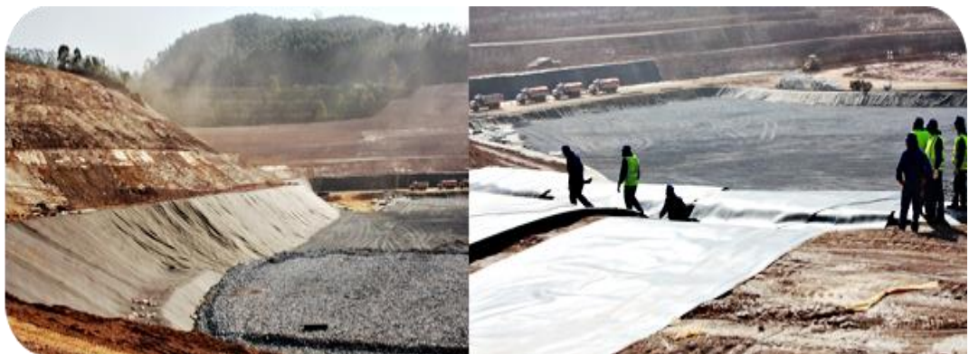
Figura 8: Aterros Sanitários (ESSENCIS, 2012).
