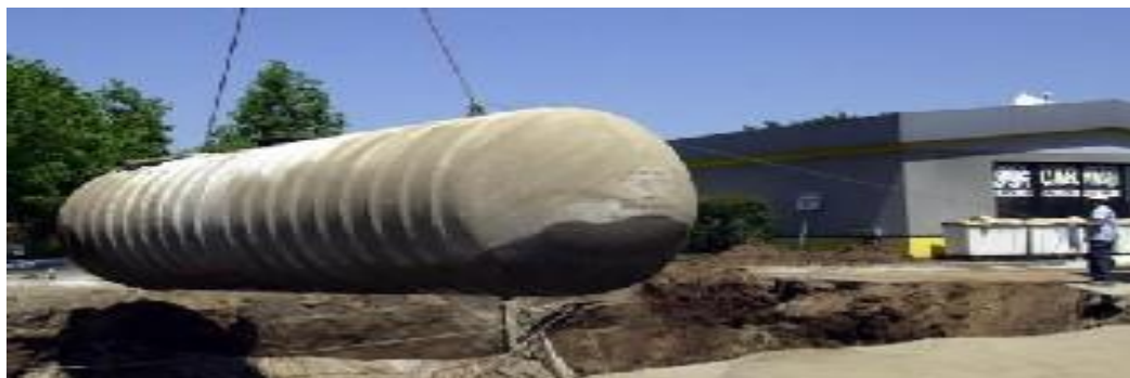
Figura 3: Vazamento em Tanque Subterrâneo (TEIXEIRA, 2012)
