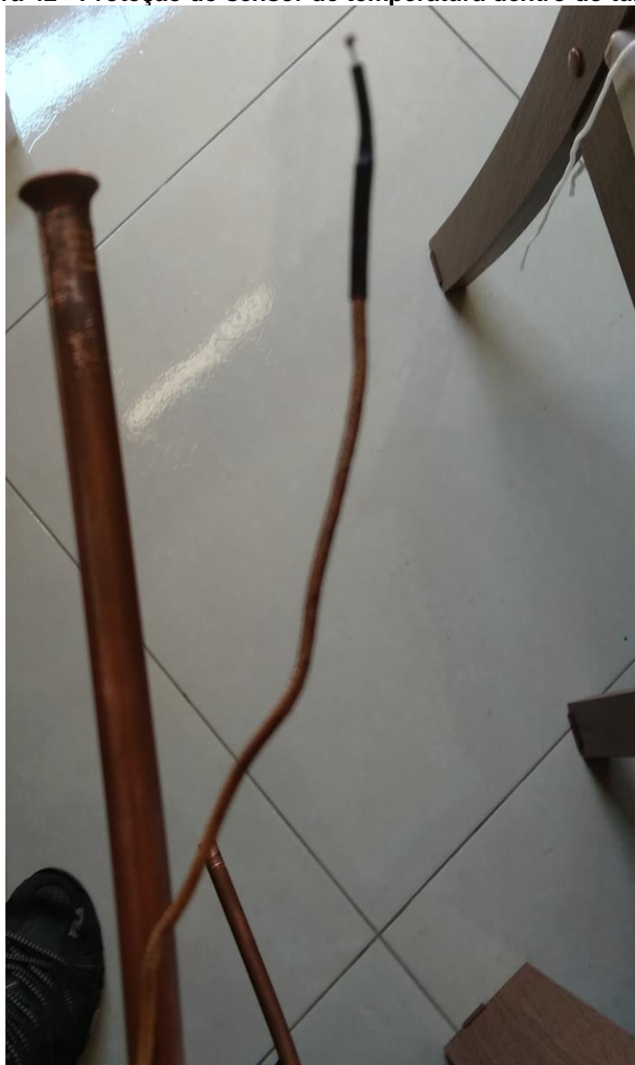
Figura 42 - Proteção do sensor de temperatura dentro do tubo de cobre.
