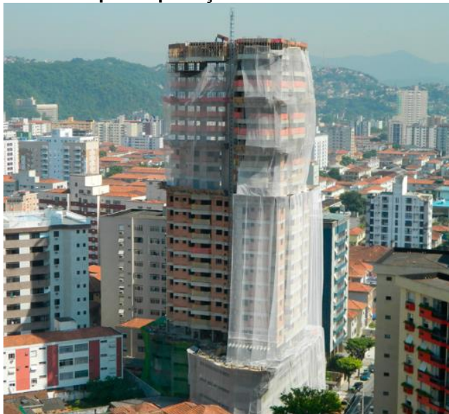
Figura 12 – Exemplo de proteção de edifício com tela fachadeira.
