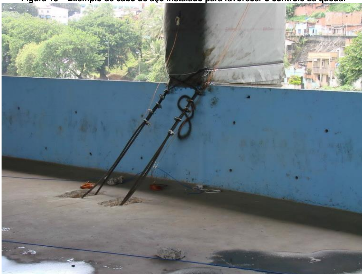
Figura 13 – Exemplo de cabo de aço instalado para favorecer o controle da queda.
