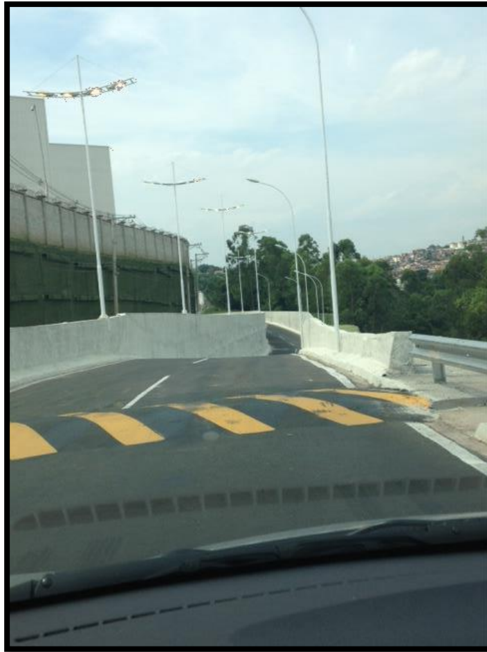
Neste local houve o desmoronamento da rua, prejudicando a estrutura do muro, que foi contido através de tirantes.
